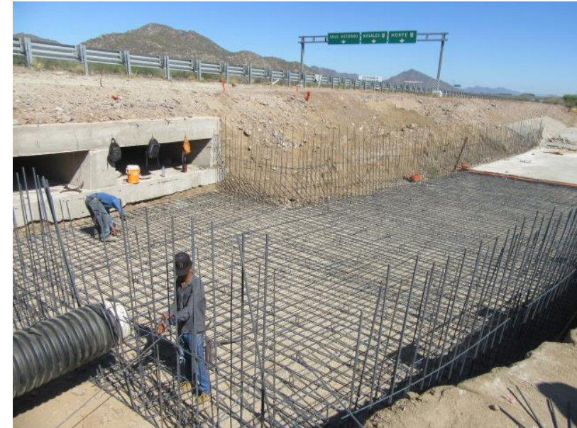
Construcción de acceso al parque de innovación y alta tecnología (PIAT) en la localidad y Municipio de Hermosillo.
